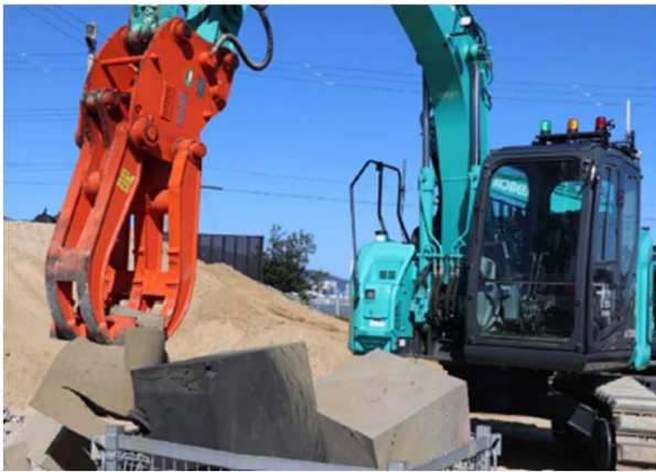
建設機械(遠隔操作) 危険エリアでの作業を、遠隔地から安全に実施
