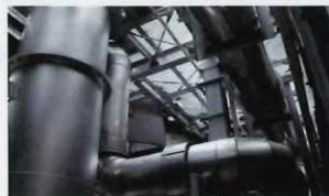
プラント配管
