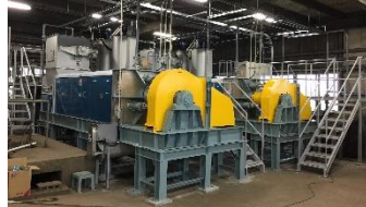
全環衛生事業協同組合・ 脱水施設
